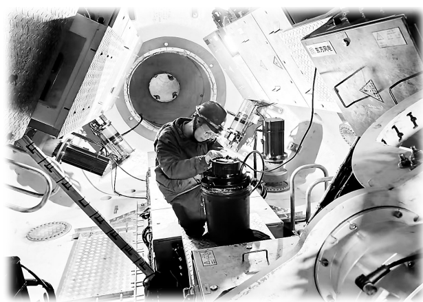
图为运维人员正在进行检修
