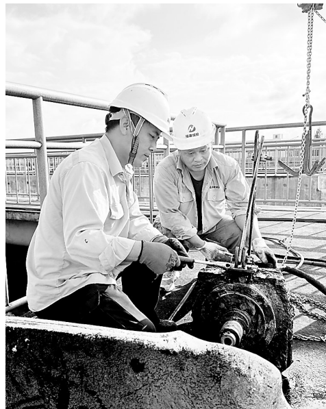
为保障设备安全、延长设备寿命,城投公司水务投发公司加强设备日常巡检和维护工作。图为近日,该公司对氧化沟A侧8号潜水推流器电机轴承进行维修更换,为污水处理厂长期稳定运行和出水达标排放奠定基础。(郑静 摄)
