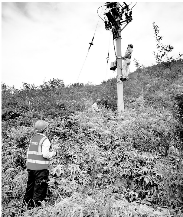
8月13日,福能新能源公司草山风电场受雷击导致场区10kV备用变跳闸。为了进一步做好迎峰度夏安全运行的生产工作,保证场区后备用电,该公司员工对场区10kV备用变进行抢修。(陈泳林 林思颢 摄)
