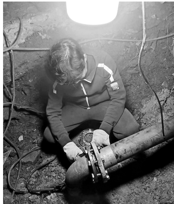
4月14日晚上7点,福建煤公司电坑市发运站区供水管道的流水异常,疑似管道破裂。机修人员连夜开挖路面,经过4个多小时的奋力抢修,终于在晚上11点左右将破裂管道抢修完毕。图为该站机修人员正在对水管进行加固。(林玉梅 摄)
