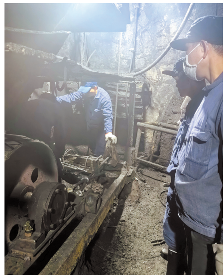
煤电公司坎市发运站提前谋划部署，进一步加强生产设备管理，夯实安全生产基础。图为2月23日该站机修人员正在对生产设备进行全面“体检”。(林玉梅 摄)
