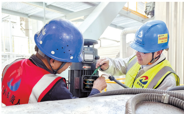
截至2月23日，福鼎市龙安化工园区各企业全面进入复工复产阶段。龙安热电公司相关部门迅速投入热网检修维护工作，确保园区供热工作安全稳定。(林雪梅 摄)
