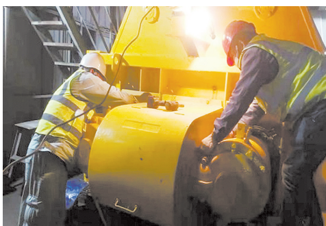
2月18日，建材控股漳州混凝土公司积极开展机械设备检修工作，为确保节后复工和日常安全生产筑起了一道坚实的屏障。(张亚茶 摄)
